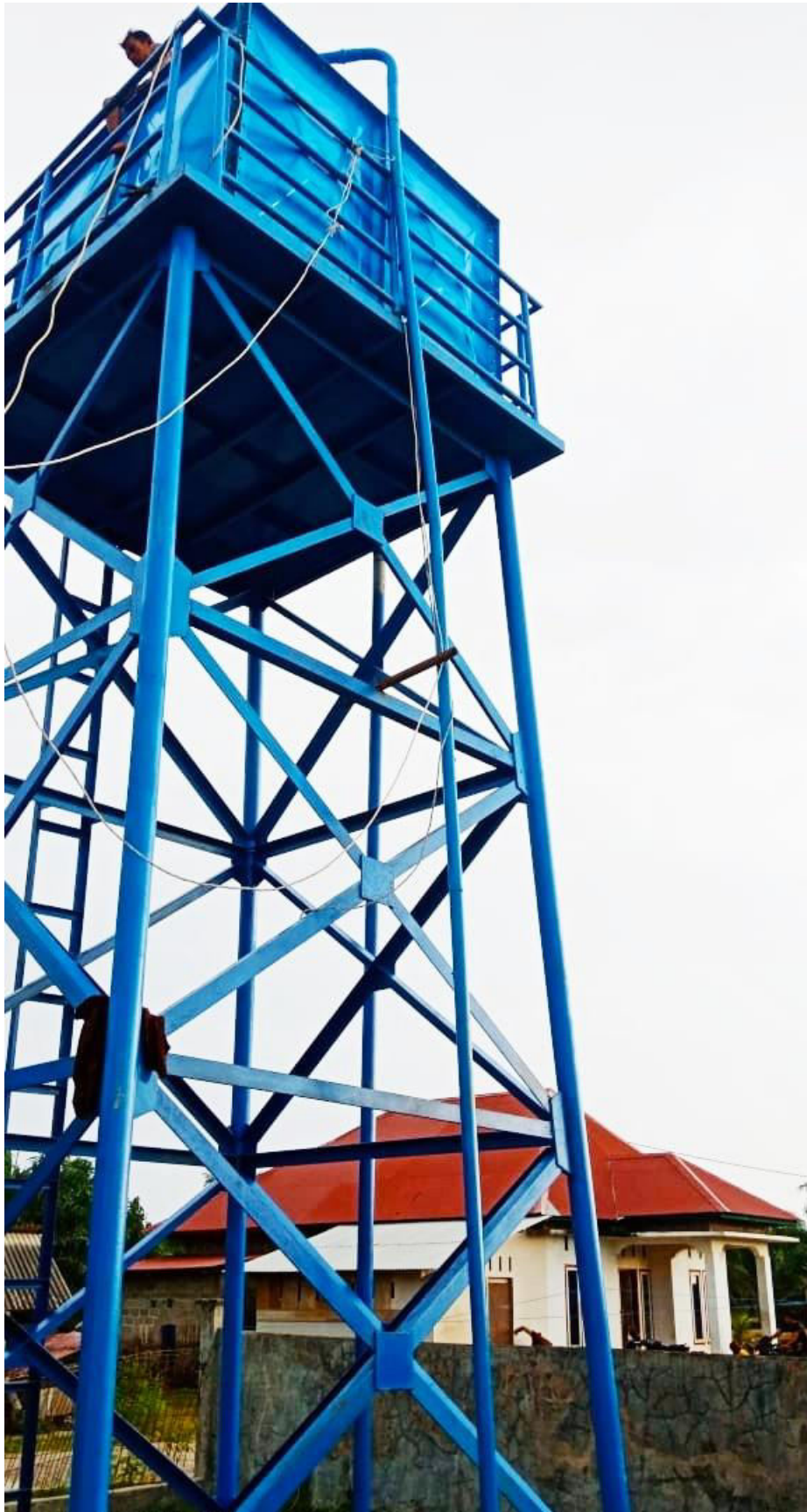
Pembangunan Prasarana Air Minum Pasir Ganting Pulau Rajo Kec. Air Pura Tahun 2019
